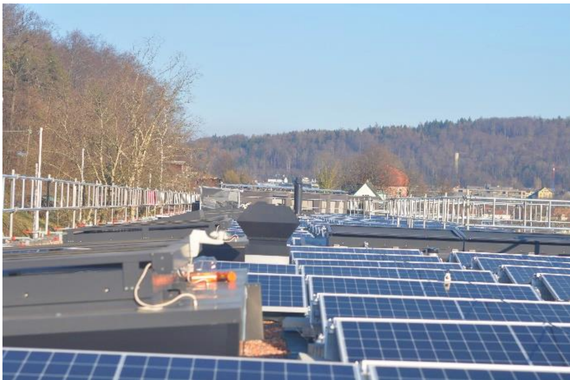
Installation photovoltaïque sur un bâtiment commercial
