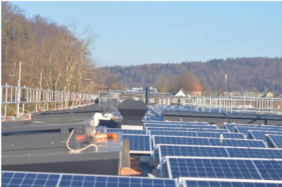
Impianto fotovoltaico su un edificio commerciale
